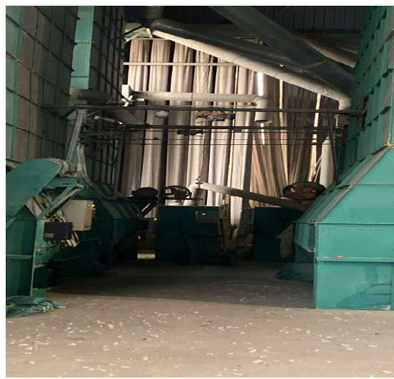
Hình ảnh hệ thống đường ống thu gom
