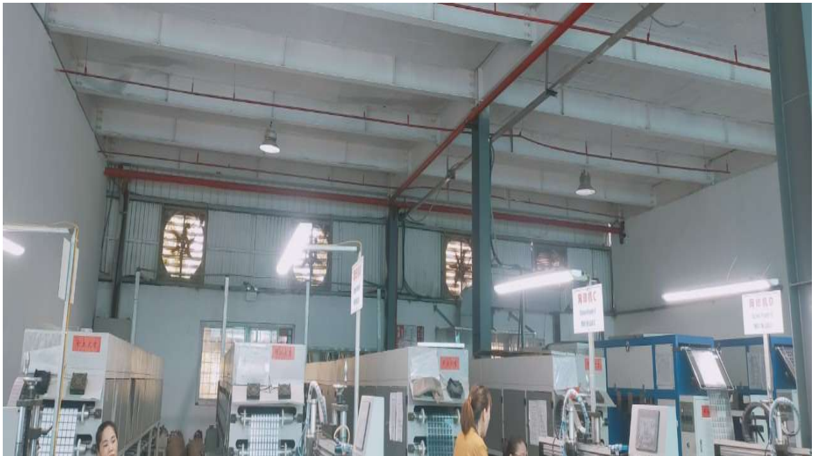
Hình 3.2. Hệ thống quạt thông gió khu vực in tem mác
